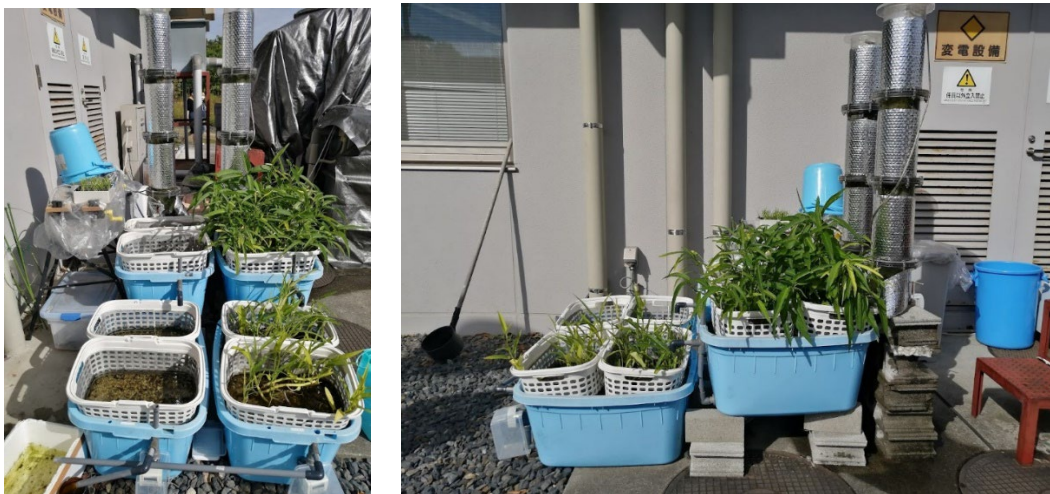
図 1 散水ろ床と人工湿地を組み合わせた廃水処理システム。
