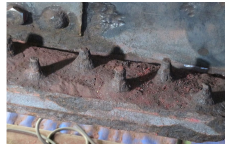
写真1 腐食高力ボルト
