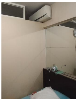
部屋にまたがって設置されているエアコン
